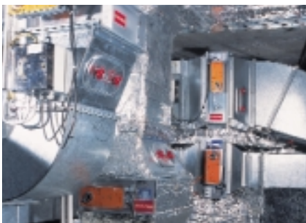
Im gesamten ZDF-Komplex sind bereits unzählige Belimo-HLK-Stellantriebe im Einsatz, beispielsweise rund 200 Rauchschutzklappenantriebe
