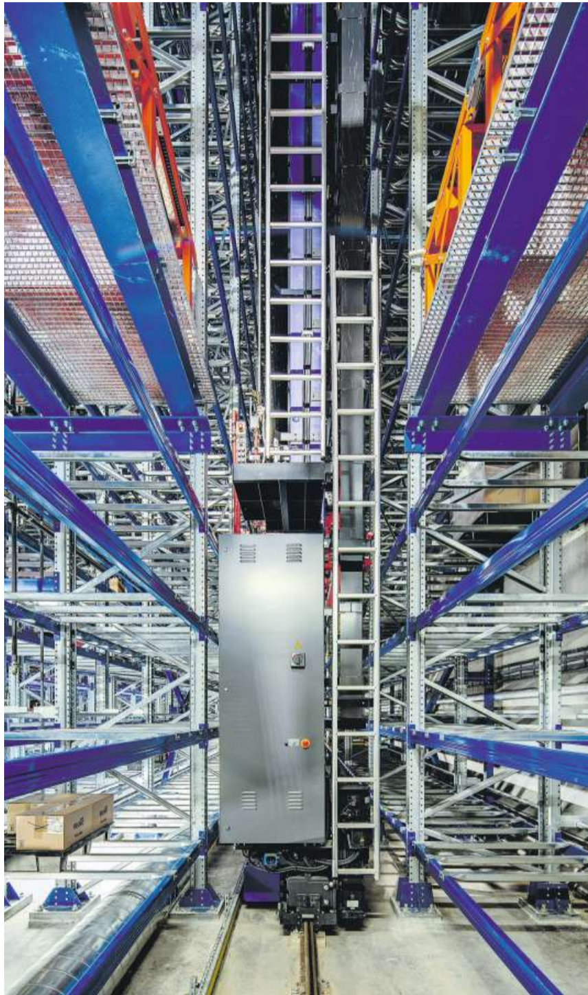
Belimo verfügt über ein vollautomatisiertes Logistikzentrum.
