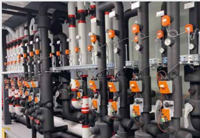
Waterzijdige verdeelunit voor verwarmen en koelen. Deze unit wordt ook gebruikt voor scholings doeleinden.
