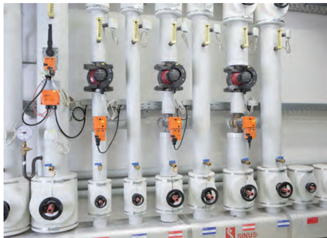
Die Energieventile sorgen auch für eine geregelte Kälteverteilung. Aktuell sind 38 Belimo Energy Valves (DN 25 bis DN 100) in allen wichtigen Bereichen der Wärme- und Kälteversorgung installiert.
