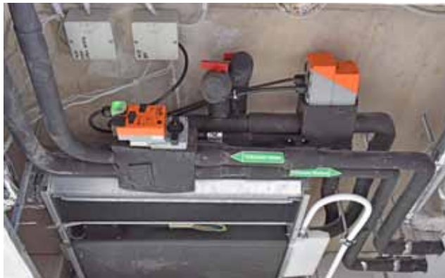
Die in die Decke eingebauten 6-Weg-Zonenventile regeln den Durchfluss von Warm- und Kaltwasser an den Gebläsekonvektoren.
