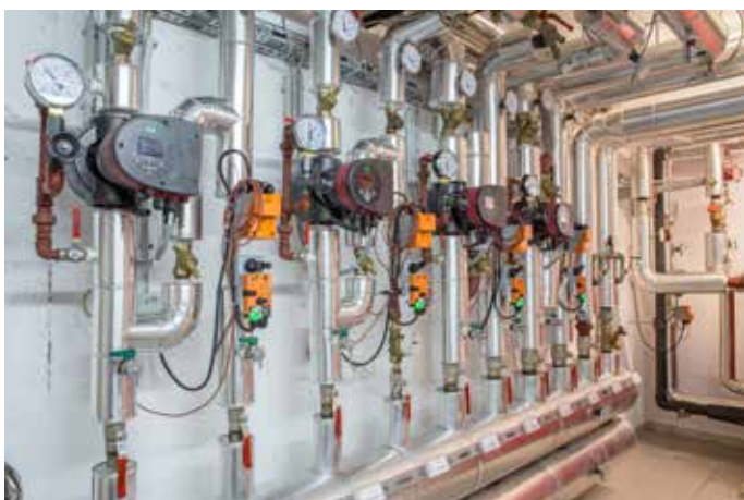
Heizungsverteiler in der Heizzentrale.
