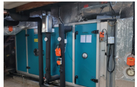
Das raumluftechnische Gerät wurde mit verschiedenen Belimo-Komponenten ausgerüstet.
