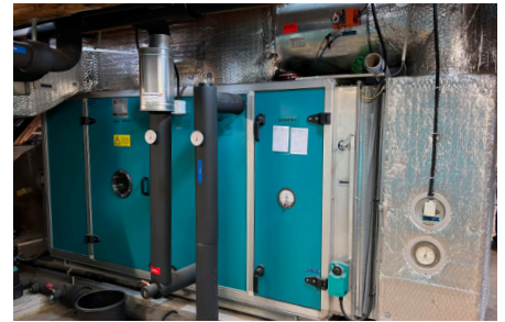
Das raumluftechnische Gerät vor den Retrofit-Massnahmen.
